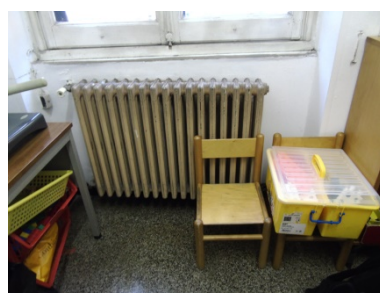
Figura 4.6 - Particolare sistema di emissione
