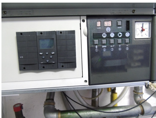
Figura 4.7 – Pannello di comando della caldaia
