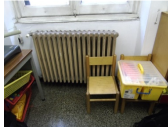
Figura 8.7 – Particolare sistema di emissione
