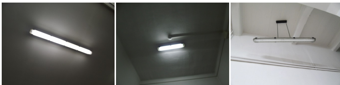
Figura 4.13 - Particolare dei corpi illuminanti
