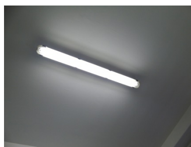
Figura 8.11 - Particolare impianto illuminazione su cui intervenire.
