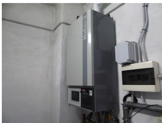
Figura 4.11 - Generatore di calore
