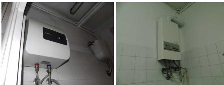
Figura 4.12 - Bollitore elettrico ad accumulo e generatore a gas per la produzione di ACS
